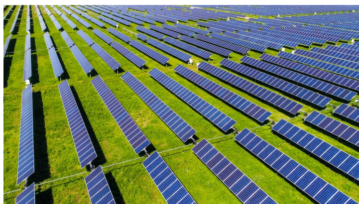
Eksempel på solcelleanlæg på terræn – solcellepanelerne følger solens bevægelse.
